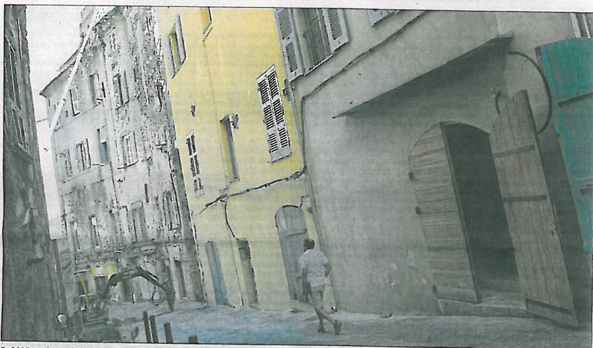
En 2005, cet immeuble de la rue droite était si dégradé qu'il avait fait l'objet d'un arrêté de péril avant d'être évacué.
